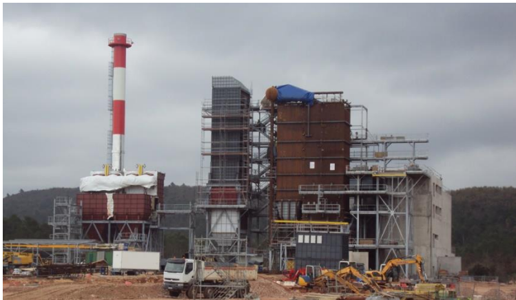
Inova Biomass plant in Brignoles, France 1 Photo: Collectif SOS Forêt du Sud
